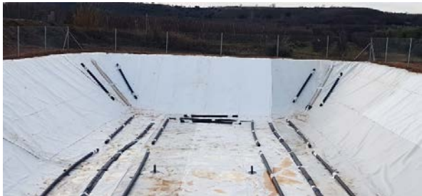
Figura 3. Bassa buida amb coberta flotant. Font: IRRIGA Water Solutions.
