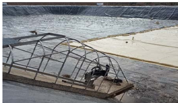
Figura 2. Sistema de protecció de l'agitador, abans de la instal·lació de la cobertura flotant. Font: DACC.
