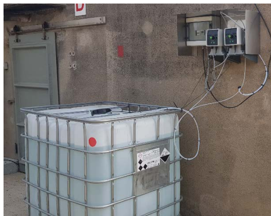
Figura 2. Sistema de dosificació a l'exterior d'una nau amb acidificació directa a fosses. Font: EMA Depuració SLU.
