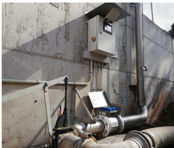
Figura 2. Conductímetre instal·lat a la bassa. Font: DARP
