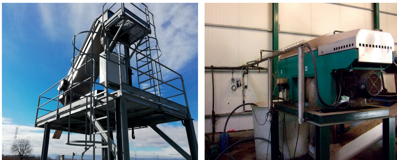
Figura 3.1.3. Imatge de l'esquerra: Sistema de separació sòlid-líquid dels purins mitjançant un tamís de rampa i un cargol premsa. Imatge de la dreta: Equip de separació sòlid-líquid de la fracció líquida dels purins mitjançant centrifugació.
